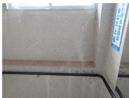
亀裂からの漏水
