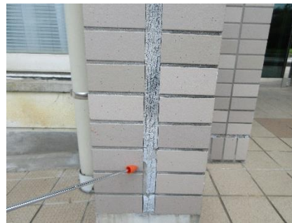
外壁目地シーリングの硬化・破断
