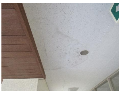
天井の雨漏り痕
