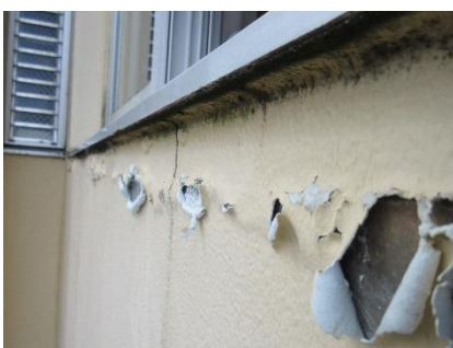
外壁の塗膜の破れ
